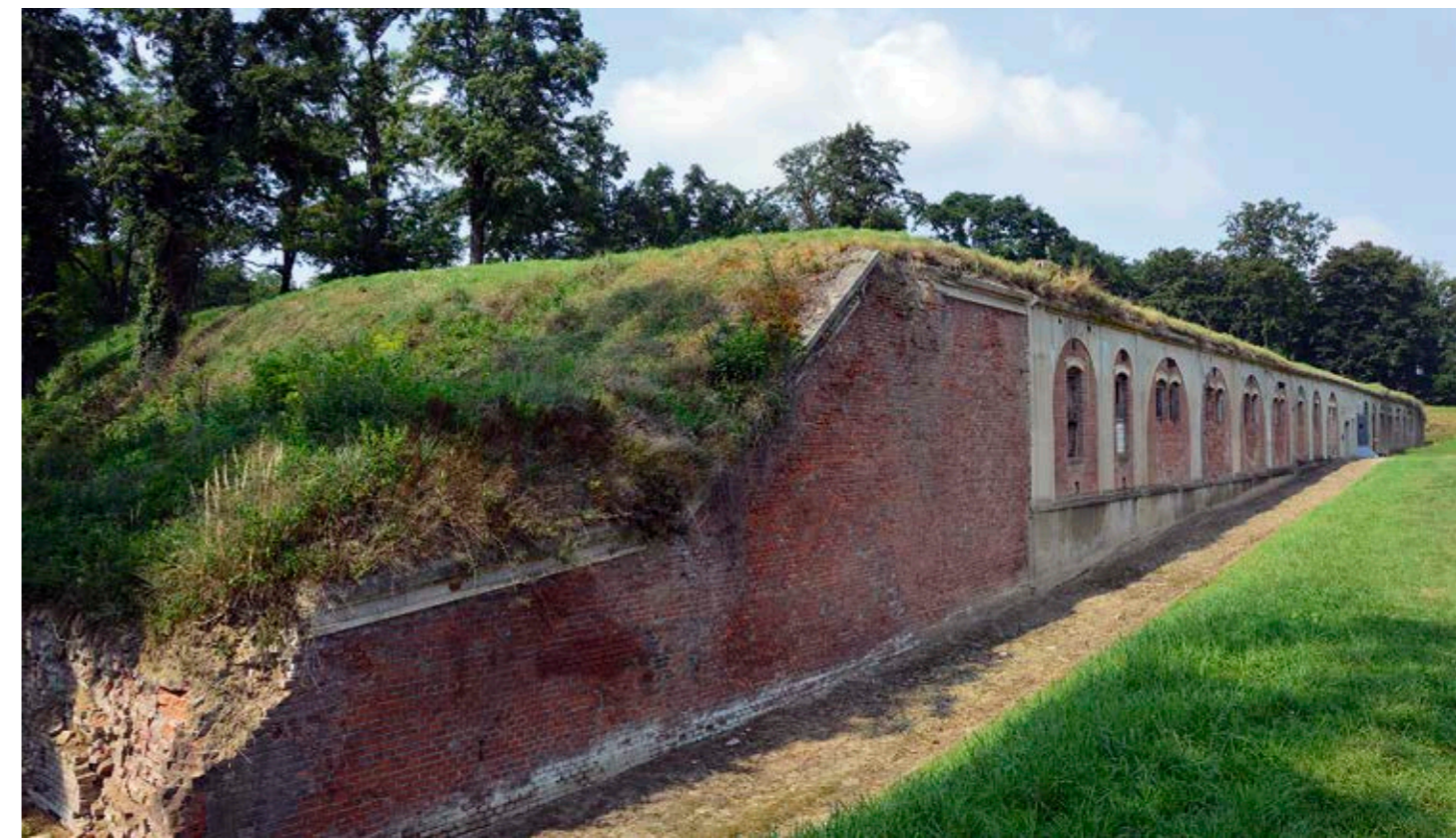
Fort W VIII „Łętownia”, centrum koszar, fot. B. Kuźniar Fort W VIII „Łętownia”, barracks center, photo by B. Kuźniar
